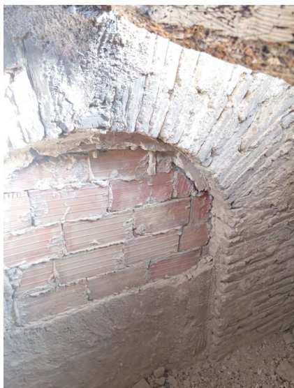
F. 20. Uno de los lunetos de la cúpula, visto desde su trasdós: se aprecia la gruesa rosca de su arco, de ladrillo a sardinel, y el fino tabique (la parte inferior es antigua, la superior, de ladrillo moderno) que lo ciega.
